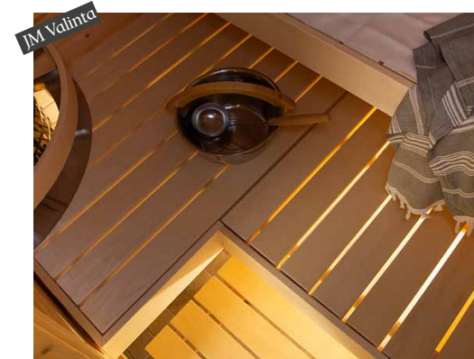
Saunan valaisin alalauteen alle, seinään asennettuna
